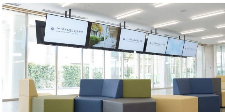
1階ラウンジにサインージとして設置された12台のブラビア
