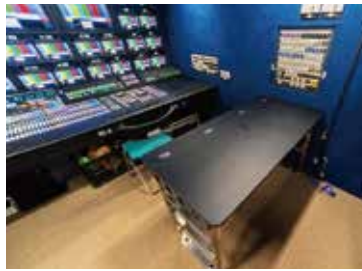
ミキサーなどを設置できるスペースに特注設計の架台
